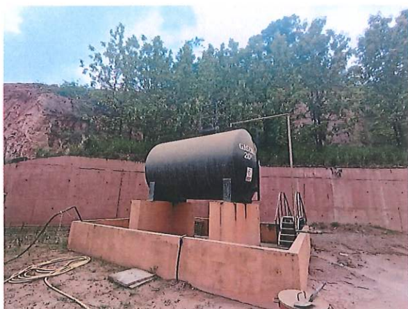
Une vue de la cuve de gasoil
