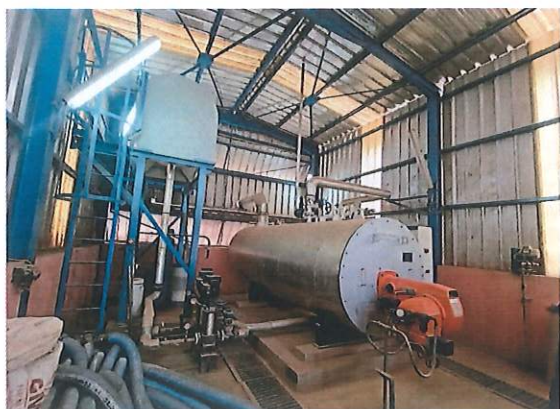
Une vue de la chaudière
