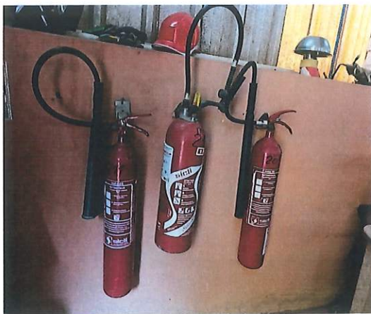
Une vue d'extincteurs sur le site
