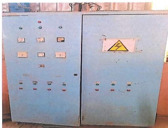
Une vue d'une armoire électronique
